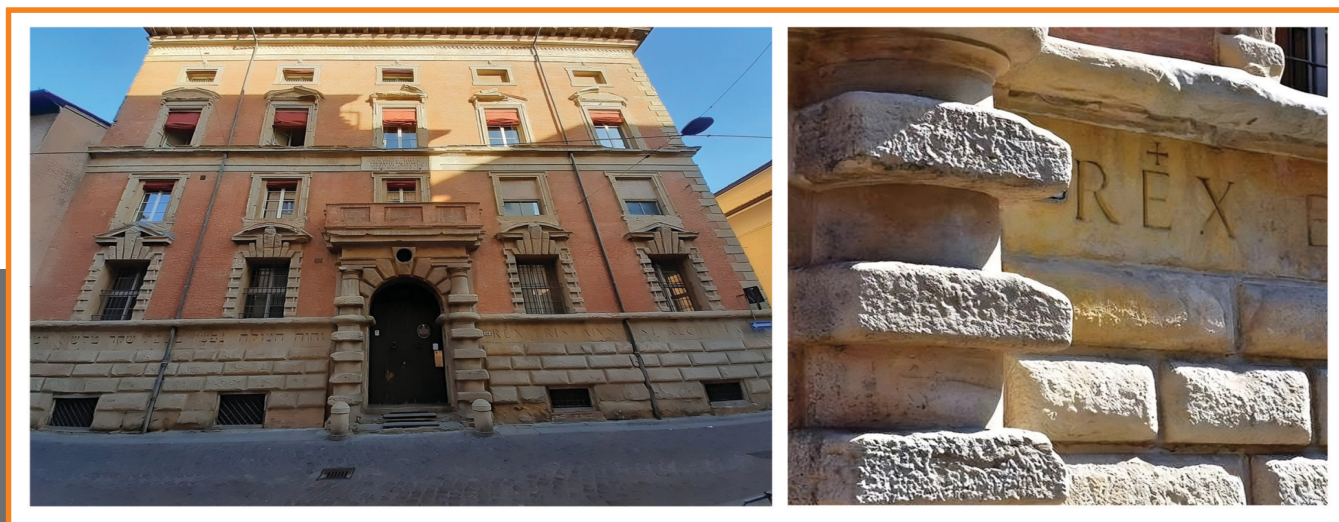
Fig.5 L'uso dell'arenaria nell'edilizia monumentale di Bologna. Palazzo Boschi, degrado del materiale lapideo The use of sandstone in the monumental architecture of Bologna. Palazzo Bocchi, deterioration of stone material
